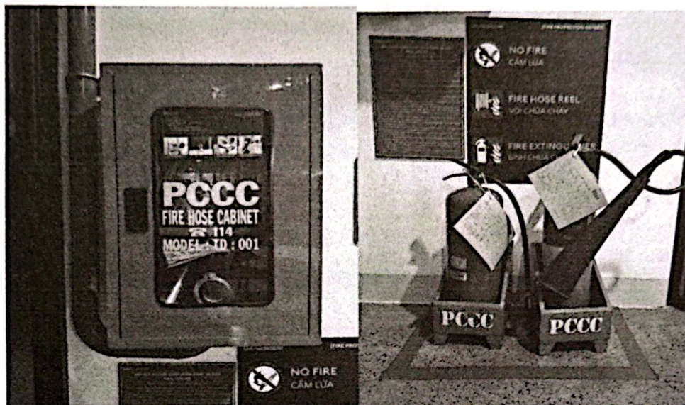
Hình 6. Một số hạng mục phòng cháy chữa cháy của Nhà máy
